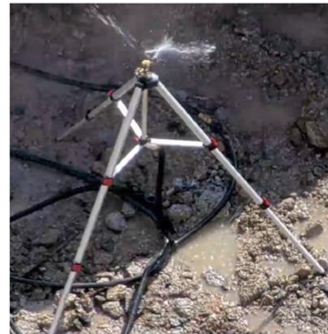
Dust Control Sprinkler 粉塵控制噴灑系統
